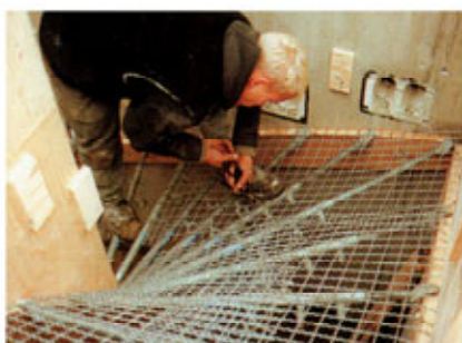
Die flexiblen Wellengitter werden auf die Teleskoprohre gelegt und mit Rödeldraht befestigt.
